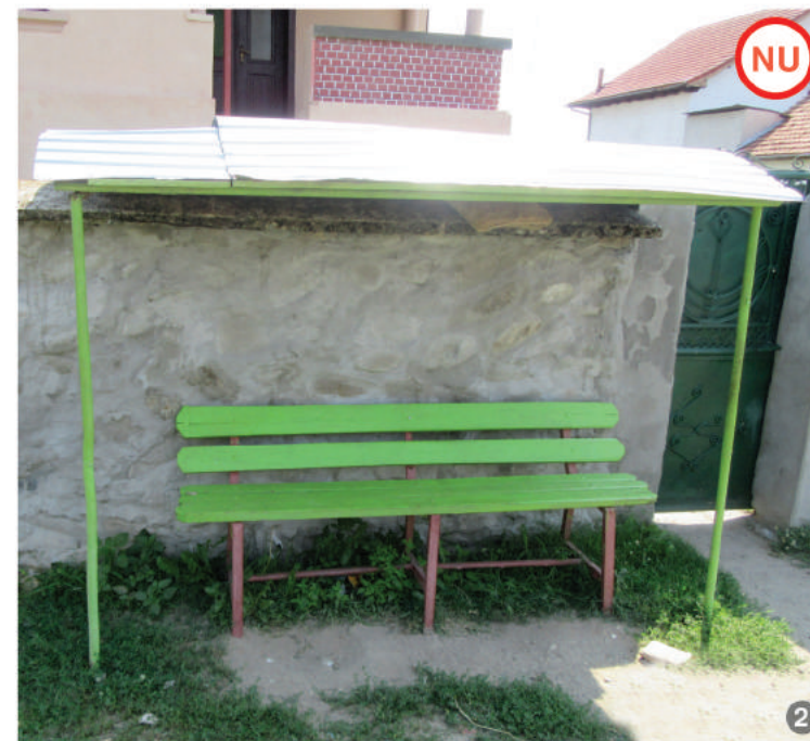
ASA NU: Amenajări exterioare nespecifice cu materiale și culori necorespunzătoare, stridente, care alterează peisajul rural specific.
