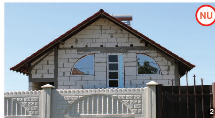
ASA NU: Goluri pentru iluminat cu formă atipică și culoare, utilizarea unui geam - oglindă.
