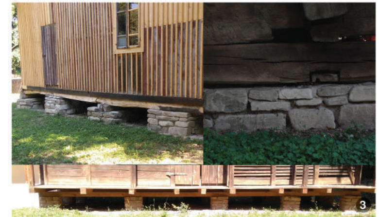
Exemple pentru rezolvarea temeliei și a soclului. Acestea sunt realizate de cele mai multe ori din piatră, însă, în zonele cu acces redus la această resursă se folosea cărămidă. În unele cazuri soclul cuprinde tot parterul care avea rol de spațiu de depozitare, obținându-se astfel condiții optime de păstrare a alimentelor. La alte construcții temelia este înlocuită de cuzineți din piatră.
