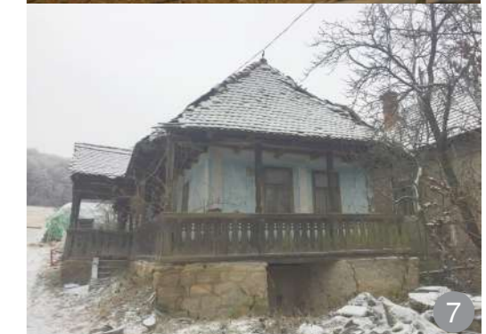
Friguriile sunt în două ape atât la casele în două ape, cât și la cele în patru ape. Friguriile fără fronton sunt cazuri izolate.
