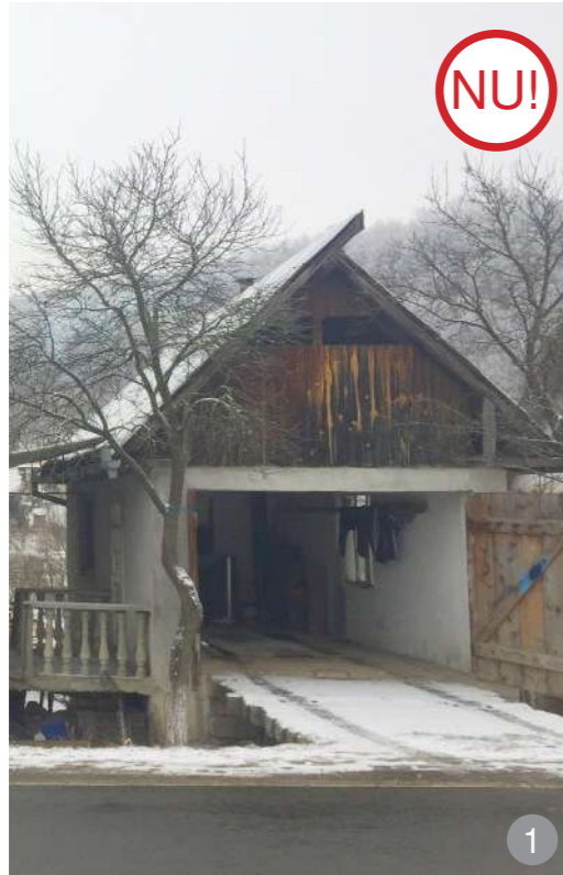
AȘA NU: Nu recomandăm construirea unor platforme de acest tip pentru accesul în garaj.
