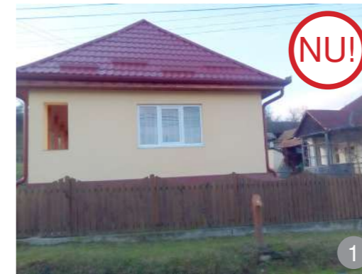
AȘA NU: Nu recomandăm înlocuirea tâmplăriilor vechi cu tâmplării PVC.
