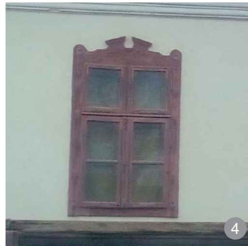
Tâmplărie cu șase ochiuri de geam, ancadrament cu urechi și fronton triunghiular întrerupt
