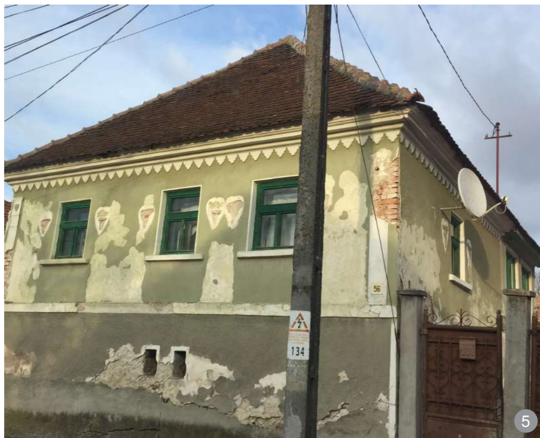
Decorațiile în formă de struguri de pe fațada de la stradă sunt grav degradate. În astfel de cazuri, recomandăm documentarea după fotografii sau după zone ale construcției unde detaliile au rămas intacte, dacă acestea există (aici există pe fațada laterală) pentru reconstituirea imaginii tradiționale.
