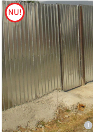
ASA NU: Nu se recomandă folosirea împrejmuirilor și a porților din tablă lucioasă, deoarece aceasta se va degrada foarte repede (sub acțiunea ploii și a altor factori mecanici).
