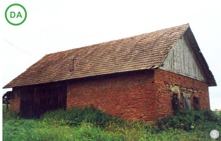
AȘA DA: Exemplul prezintă o structură de zidărie portantă la parter, iar la etaj, schelet de lemn și umplutură de cărămidă. (Transilvania)
