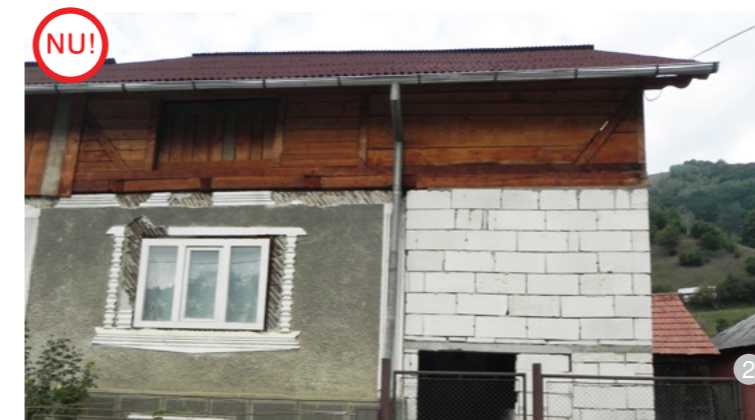
AȘA NU: Pentru intervențiile noi, completările și reparațiile se recomandă a se realiza din materiale compatibile: cărămidă, lemn, pământ.
