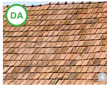
AȘA DA: Țiglă veche, recondiționată prin îndepărtarea lichenilor. Poate constitui o variantă economică, dar nu este recomandată în toate intervențiile, din cauza timpului consistent necesar curățării ei.
