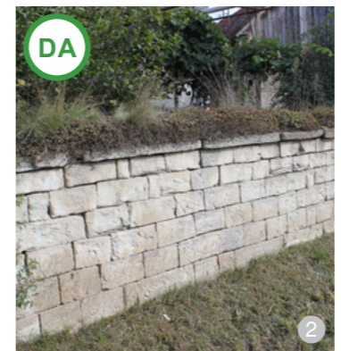
ASA DA: Exemplu de împrejmuire din satul Chidea (județul Cluj): zidărie din piatră peste care s-a pus un capac tot din piatră, pământ și plante.
