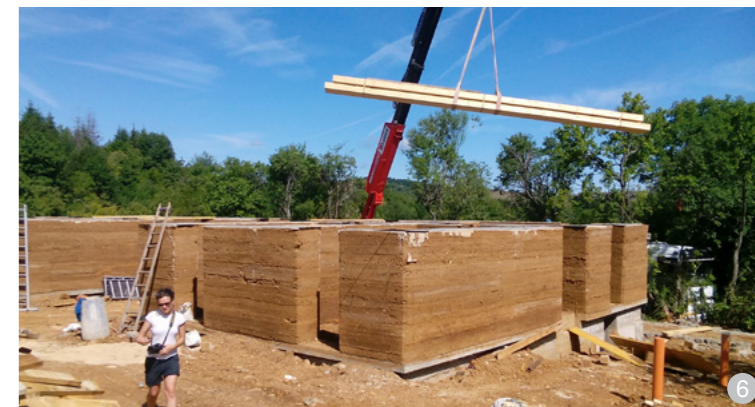
AȘA DA: Construcții noi cu pereți din pământ (sau pereți din puzderie de cânepă cu liant pe bază de var hidraulic și nisip).
