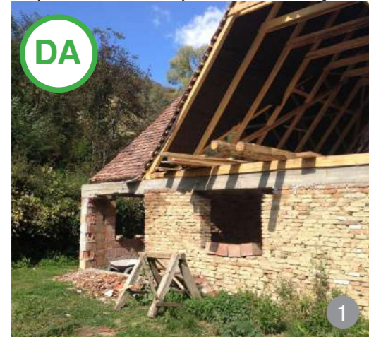
AȘA DA: Exemplul unei anexe în care panta acoperișului are o valoare adecvată.
