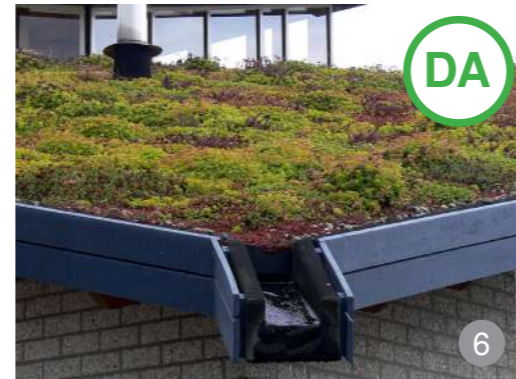
AȘA DA: Recomandăm acoperișurile vegetale atunci când se dorește integrare în peisaj a construcțiilor de tip monovolum.
