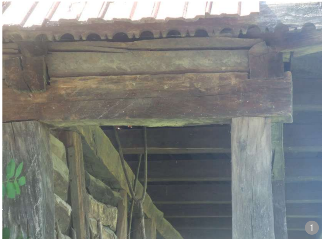
Stâlpii de lemn ai târnațului sprijină cununile pe care reazămă grinzile planșeului.
