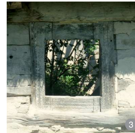
Lăcaș decorat cu incizii în „unghii”, în pereți din grinzi de lemn, pentru fereastră simplă din lemn.
