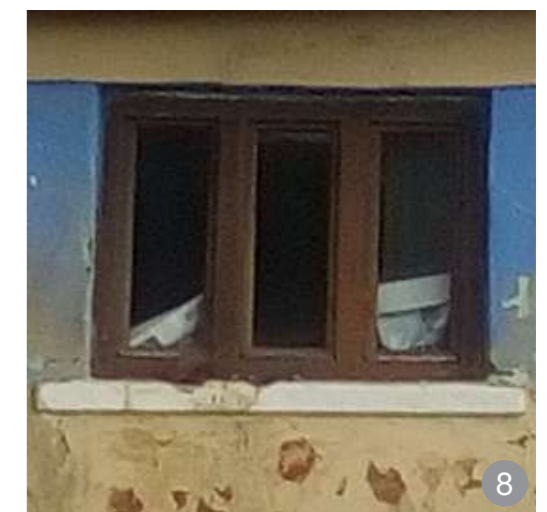
Ferestre moderniste cu trei canaturi, amplasate în fațada principală, apar frecvent la casele interbelice și postbelice.
