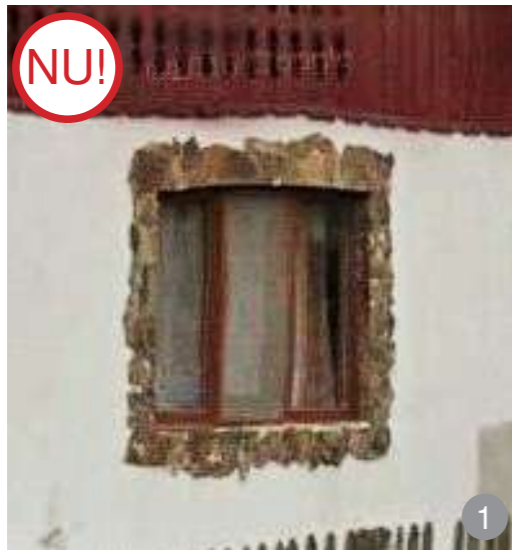
AȘA NU: Nu este recomandată utilizarea de ancadramente nespecifice (satul Băbiu).
