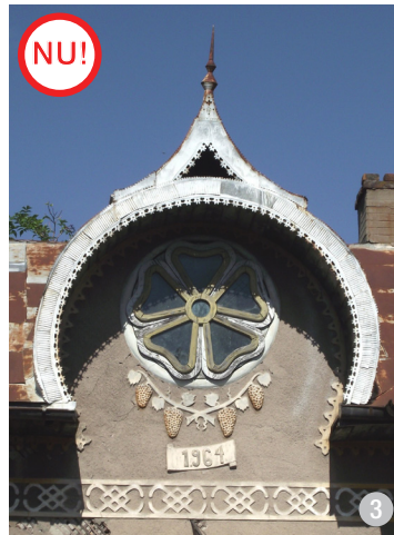
AȘA NU: Este interzisă folosirea ferestrelor cu forme străine de tradiția locală, ca în acest exemplu: fereastră în formă de floare pe fațada unei case construite în anul 1964.
