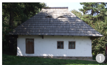
Casă veche, fără spații semideschise adiacente, dar cu streșini largi. Pereții sunt lutuți și văruiți.
