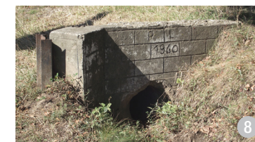
Detaliu de podeț peste șanțul străzii, realizat din beton în anul 1960, cu tencuială care imită zidăria de cărămidă.
