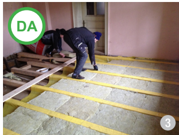
AȘA DA: Izolarea podurilor și a pardoselilor cu materialele ecologice este recomandată. În imagine, detaliu de compunere.
