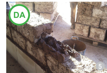
ASA DA: Case cu schelet din lemn și pereți din baloți de paie (4) sau cu pereți din blocuri de argilă amestecată cu paie (5).
