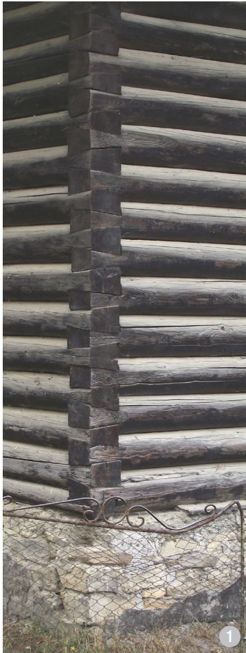
Detaliu de pereți din bârne de lemn cioplite pe două fețe, încheiate la colțuri nemțește.
