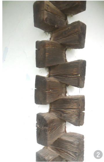
Detaliu de pereți din bârne de lemn cioplite, încheiate la colțuri în căței. În acest exemplu pereții sunt lutuiți și vâruți iar cheitorile rămân aparente.
