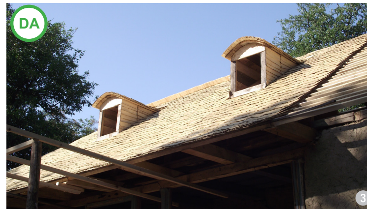
AȘA DA: Reconstituirea lucarnelor și a învelitorii de șindrila la o veche casă, în curs de restaurare.
