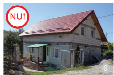
AȘA NU: Ridicarea acoperișului prin adăugarea unor rânduri de BCA nu este o soluție recomandată. Se poate obține aceeași suprafață locuibilă măbind panta acoperișului.
