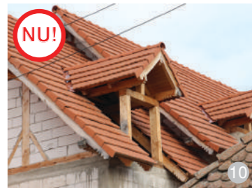
AȘA NU: Folosirea unei țigle care o imită pe cea ceramică (țigle din beton, tablă etc.) are un efect contrastant cu învelitoarea istorică din imagine.
