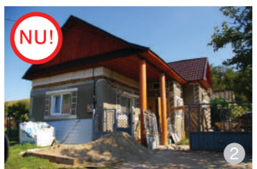
AȘA NU: Nu se recomandă realizarea de acoperișuri cu panta mai mică de 45°, deoarece spațiul din interiorul șarpantei nu poate fi folosit ca spațiu locuibil.
