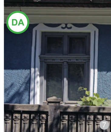
AȘA DA: Se recomandă repararea ferestrelor originare și nu înlocuirea lor cu altele noi, cu tâmplăria de PVC, cele din lemn fiind mult mai frumoase și adaptate la nevoile construcțiilor vechi. Montarea de tâmplărie PVC poate duce la apariția igrasiei.
