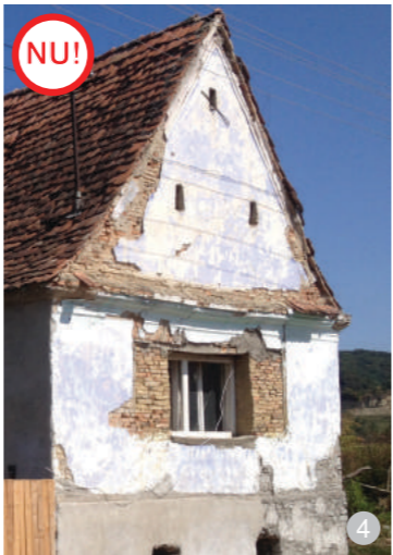
AȘA NU: Caz frecvent de modificare inadecvată a golurilor ferestrelor de la fațadă: prin amenajarea unui gol în axa frontonului, se slăbește stabilitatea acestuia, riscând să apară fisuri.
