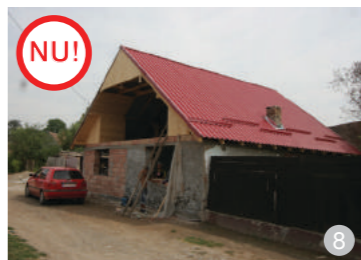
AȘA NU: Folosirea tablei ridică o gamă largă de dificultăți, plecând de la problema reciclării ei până la probleme de onestitate: imitarea prin culoare și formă a țiglei ceramice. Cele mai mari probleme rămân însă cele legate de aspect, de încălzire excesivă, care poate crea un disconfort vara într-o mansardă locuită, și de zgomot pe timp de ploaie sau grindină. În cele din urmă, tabla este un material ieftin, importat din zona construcțiilor industriale, unde până de curând nu a contat aspectul finsajului.
