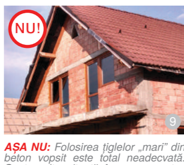
AȘA NU: Folosirea țiglelor „mari” din beton vopsit este total neadecvată. Sunt multe situații în care acestea s-au decolorat, nemaținând cont de aspectul nepotrivit al formei importate.
