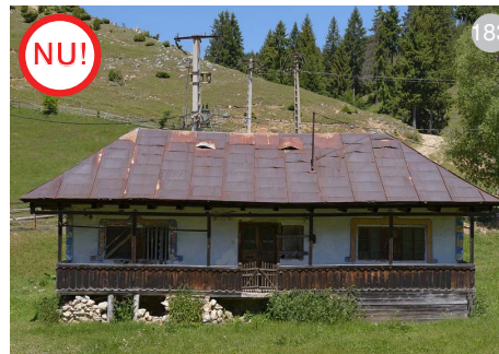
AȘA NU: Învelitoare din tablă, neîntreținută, la o casă tradițională din satul Fundățica, comuna Fundata.
