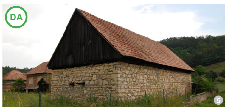
AȘA DA: Șură reparată corect și refuncționalizată: zidăria a fost reparată, acoperișul a fost refăcut cu țigile originare și șarpanta a fost consolidată cu elemente noi: ea se încadrează perfect în peisajul gospodăriei (imagine din satul Nădășel).
