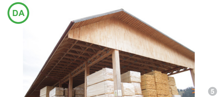
ASA DA: Utilizarea unei structuri din lemn lamelar sau a unei zăbrele poate fi o soluție practică pentru realizarea clădirilor cu deschideri mari.
