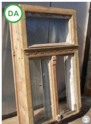
ASA DA: Ferestrele tradiționale merită restaurate atunci când se prezintă în condiții acceptabile. Elementele degradate din lemn trebuie înlocuite, feroneria făcută să funcționeze din nou, iar întreg ansamblul trebuie protejat de o peliculă de vopsea.
