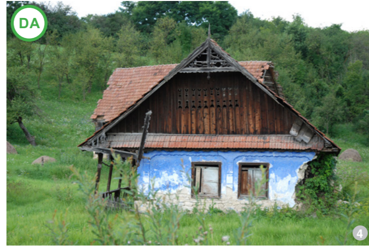
Existența nenumăratelor ruine, în general, clădiri al căror acoperiș s-a prăbușit, a făcut ca unii arhitecți să acorde o importanță sporită conceptului de intervenție pe restaurare (imagine din satul Gârbău).
