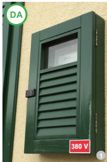
AȘA DA: Mod de mascare și de protecție a unui contor electric.
