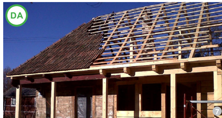
AȘA DA: Exemplul unei șarpante simple, un sistem care se folosește regulat în centrul Transilvaniei (imagine din satul Roșia Montană).
