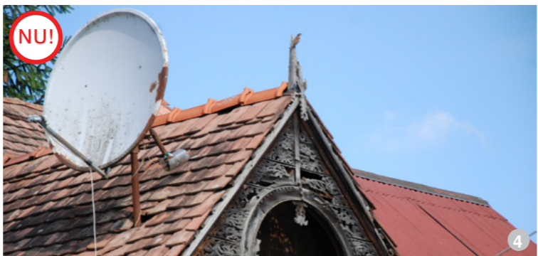
AȘA NU: Se interzice fixarea instalațiilor pe fațade sau învelitoare, deoarece acestea provoacă atât daune, cât și afectarea imaginii casei. (Aghireșu)
