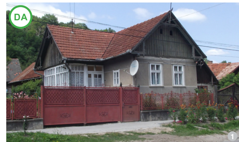
AȘA DA: Extindere corectă de casă, cu învelitoare din țiglă ceramică trasă (imagine din satul Tețișu)
