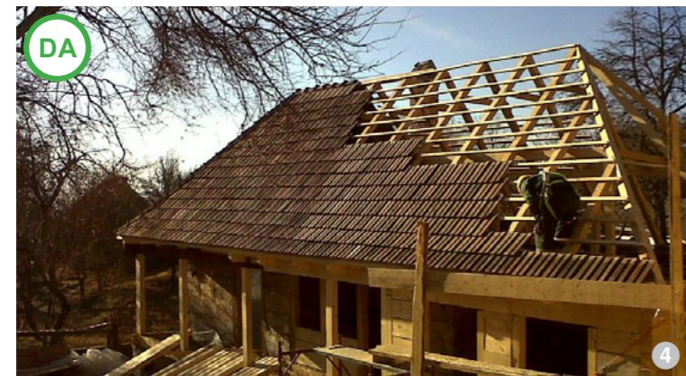
ASA DA: Utilizarea unei soluții locale de realizare a șarpantei. Astfel, se susține economia locală, prin utilizarea forței de muncă și a materialelor din zonă (imagine din satul Roșia Montană).
