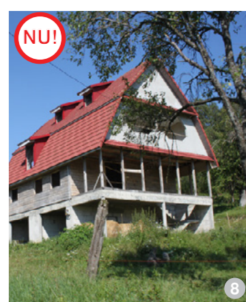
AȘA NU: Volumetria acoperișului cu ruperi de pantă nu este caracteristică acestei zone. Realizarea unui acoperiș cu pantă foarte mare (peste 60°) este costisitoare, iar spațiul rezultat deasupra primului nivel de mansardă rareori este folosit, din cauza dimensiunilor reduse și a accesului dificil.
