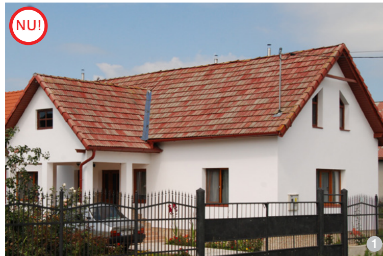
AȘA NU: Nu este permisă modificarea gurilor de aerisire în vederea amplasării unor ferestre. Aceasta aduce grave modificări aspectului general al fațadei.
